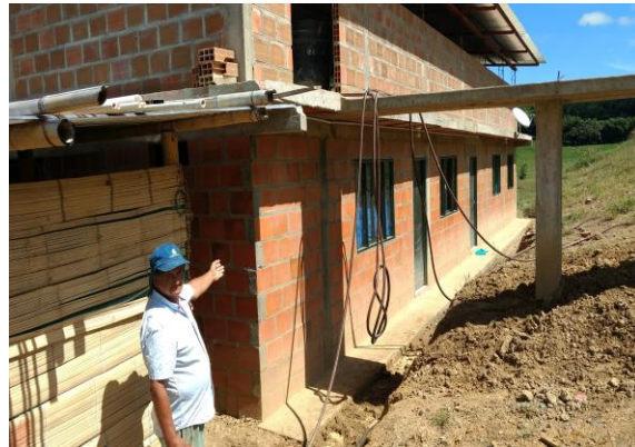
Figura 2 – Vivienda generación vertimientos líquidos
