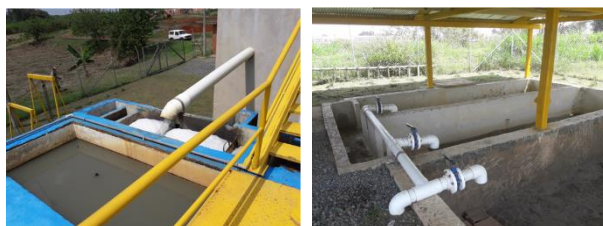
Fotografías 7. A la izquierda: vista del módulo viejo (PTAR antigua), utilizado como filtro final. A la derecha: vista de los lechos de secado.
