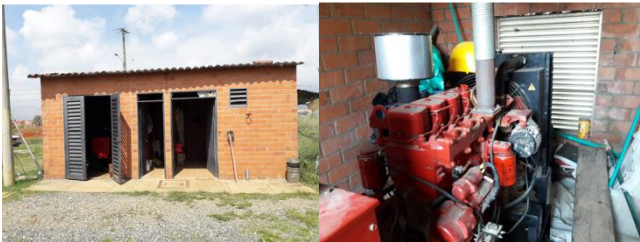
Fotografías 1. Vista de la Caseta y de la Planta Eléctrica Diésel
