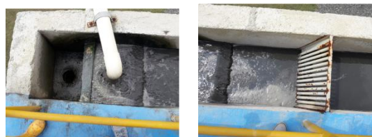
Fotografías 4. A la izquierda: vista de la cámara de llegada y de rebose. A la derecha: vista del desarenador con su rejilla.
