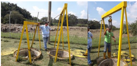
Fotografías 2. A la izquierda, vista de los dos pozos de ingreso del agua residual, con sus estructuras metálicas de soporte. A la derecha, se observa el polipasto manual de cadena, para izado de canastilla
