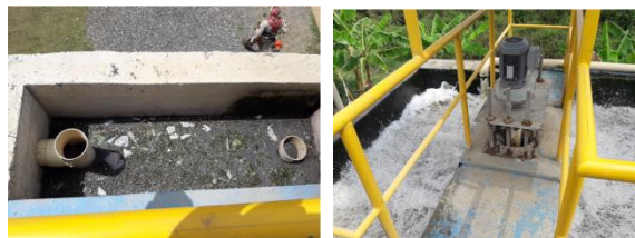
Fotografías 5. A la izquierda: trampa de grasas. A la derecha: Tanque de Aireación, con Aireador funcionando
