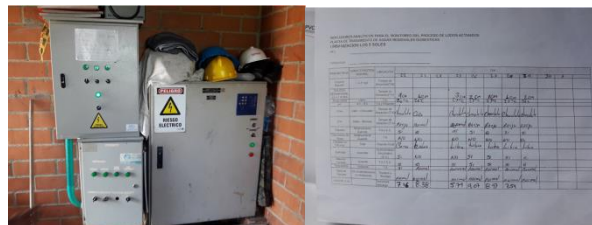
Fotografías 3. Vista de Tableros de Control y de Formatos de Indicadores
