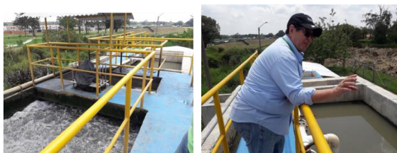
Fotografías 6. A la izquierda: aireador fuera de operación. A la derecha: sedimentador secundario.
