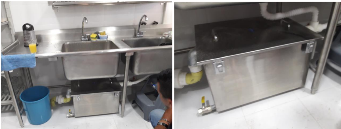
Fotografías 1. Trampa de Grasas de la Cocina: vista general y detalle.
