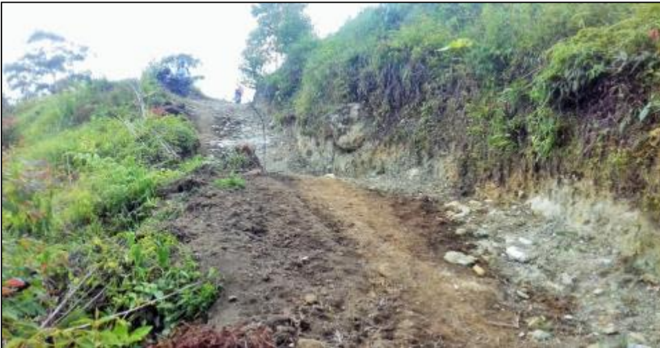
Figuras 6, 7, 8 y 9. Vía abierta con pica y placa con un ancho entre 2,5 y 3,10 metros; sin tratamiento de taludes, sin adecuación y construcción de cunetas y disipadores de agua.
