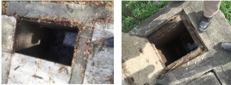
Imagen 1. Filtro Anaerobio que trata las ARD de los pozos sépticos 2,3 y 4.
