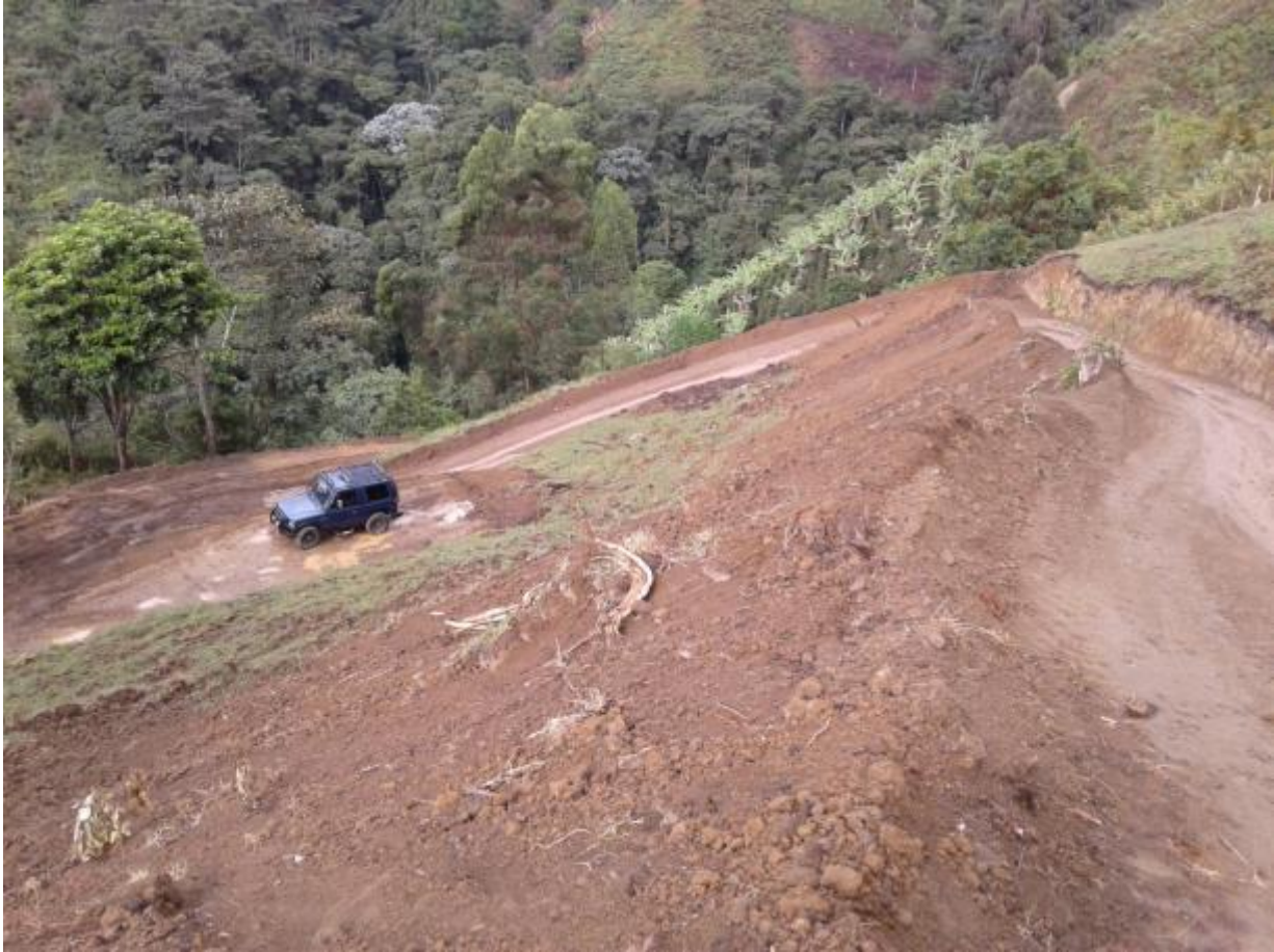
Foto No 3, se observa la disposición inadecuada del material resultante de los cortes de la vía sobre la zona de alta pendiente lo que puede generar arrastre del mismo en épocas de lluvias fuertes y afectar la vía interveredal ubicada en la parte baja.
