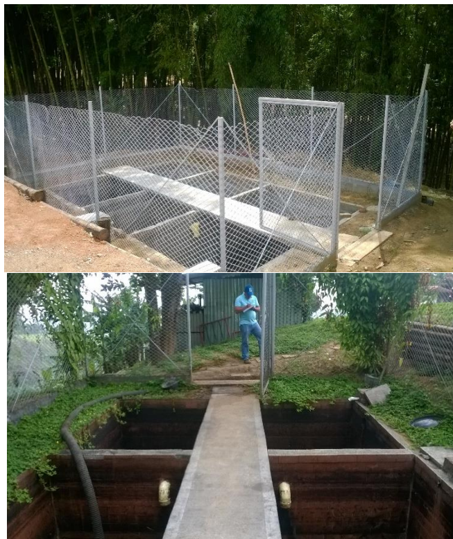
Sistema de tratamiento de aguas mieles luego de pasar por el sistema Belcosub.
