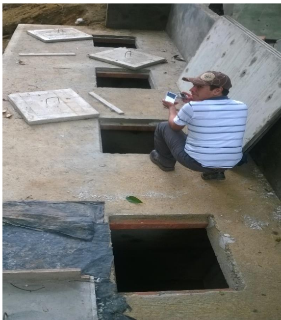
Pozo séptico predio la Tesalia
