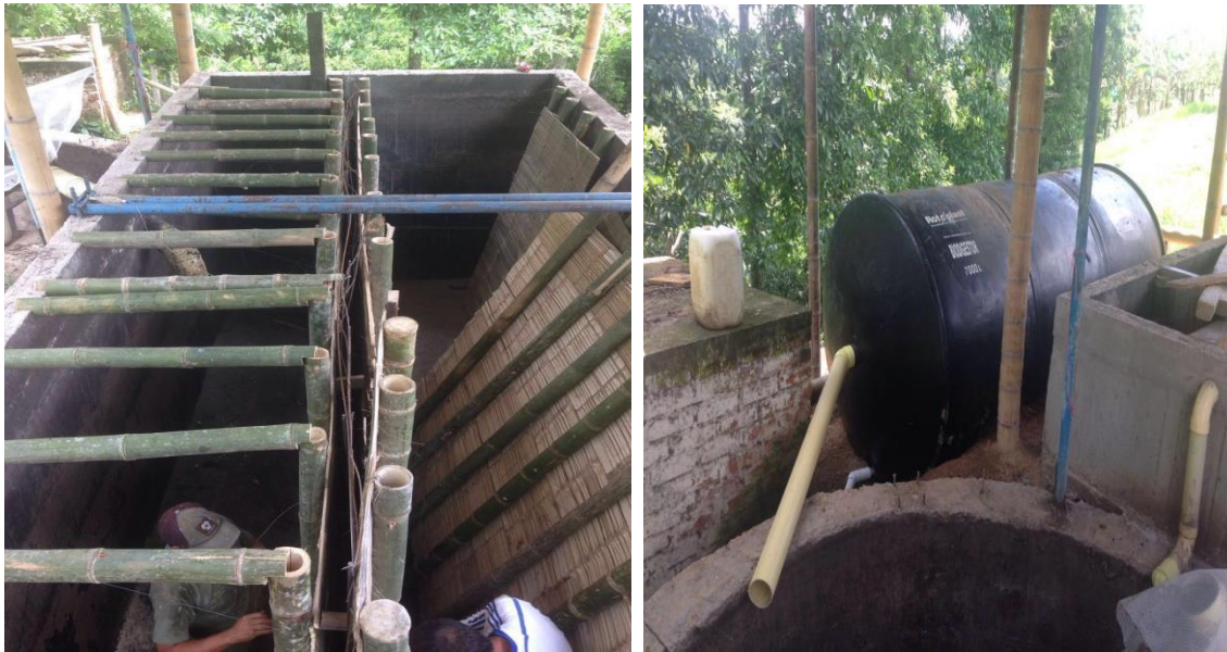
Foto 5 y 6. En la foto 5 se observa el sistema compuesto un sedimentador de alta tasa y un biodigestor
