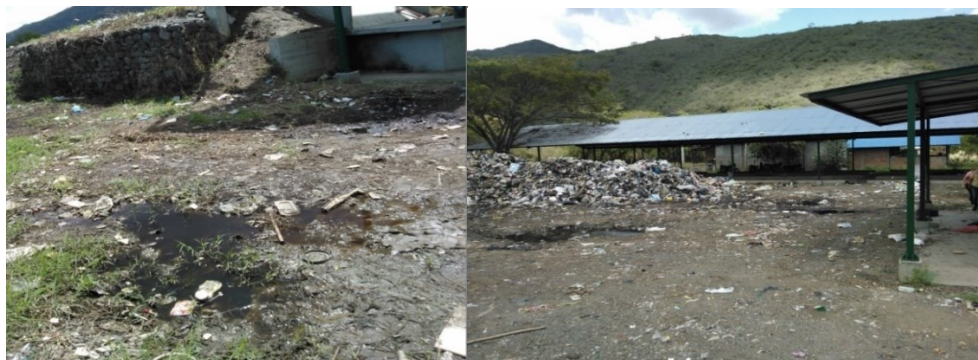
Imagen No. 7 y 8 – Vista de área de descarga con presencia de lixiviados (Arriba); Vista detalle de presencia de lixiviado drenando e infiltrándose en el suelo (Abajo). Fuente CVC, 2014.
