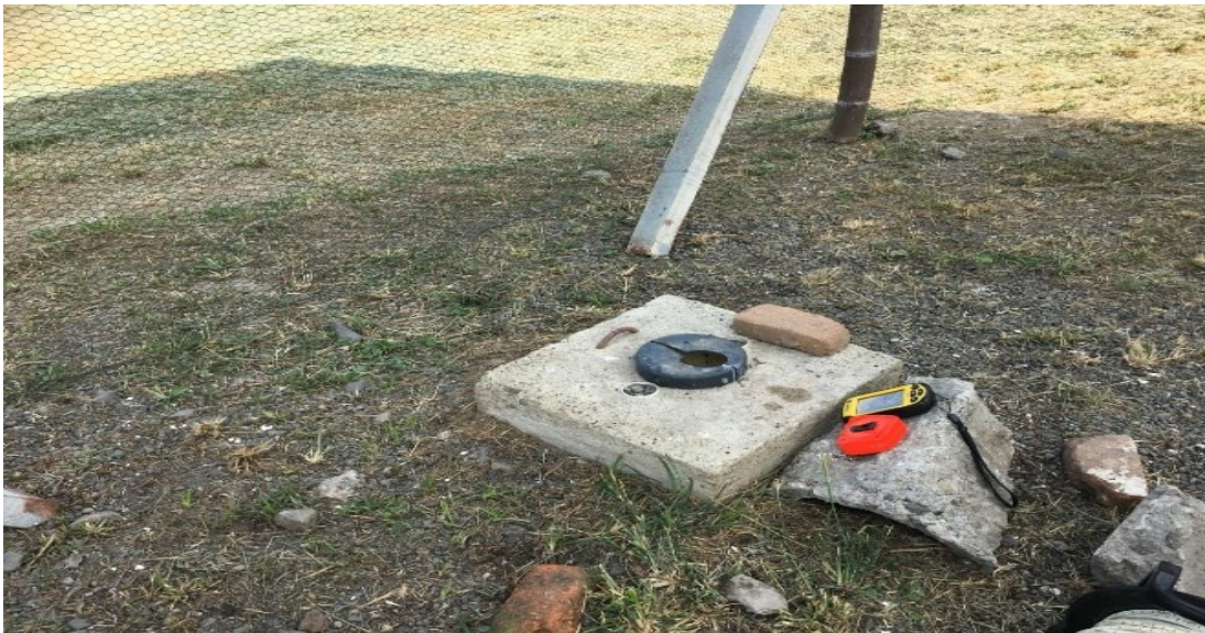
Foto No.1 Vista general del Pozo
