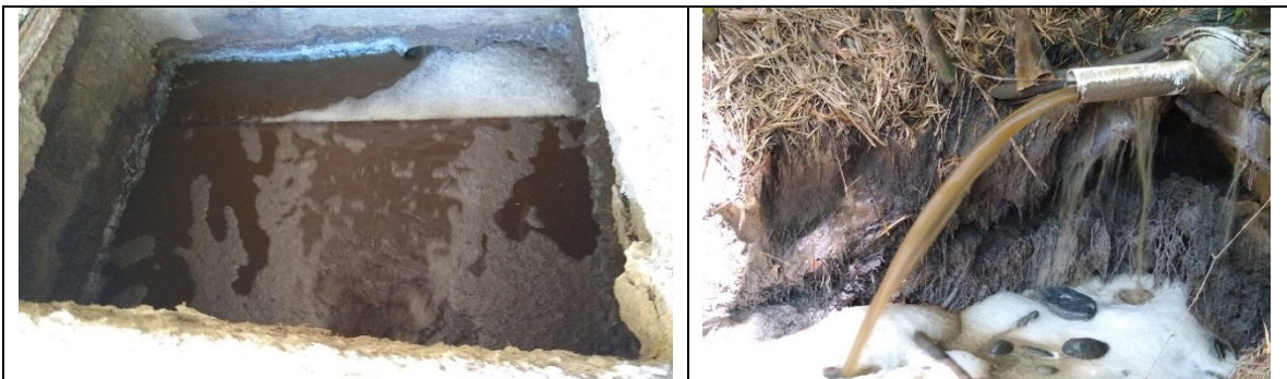
Imágenes 3 y 4. Salida efluente de la PTAR y descarga del vertimiento al río Morales
