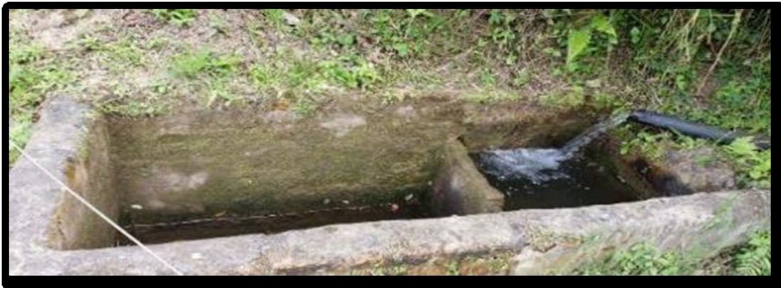
Imagen 3 donde se observa el Tanque desarenador
