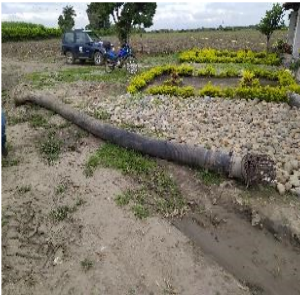
Foto 5. Granada empleada para el Bombeo
