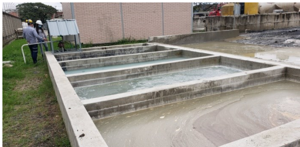
Foto 3. Sedimentador con motobomba para recirculación y reúso de agua tratada.
