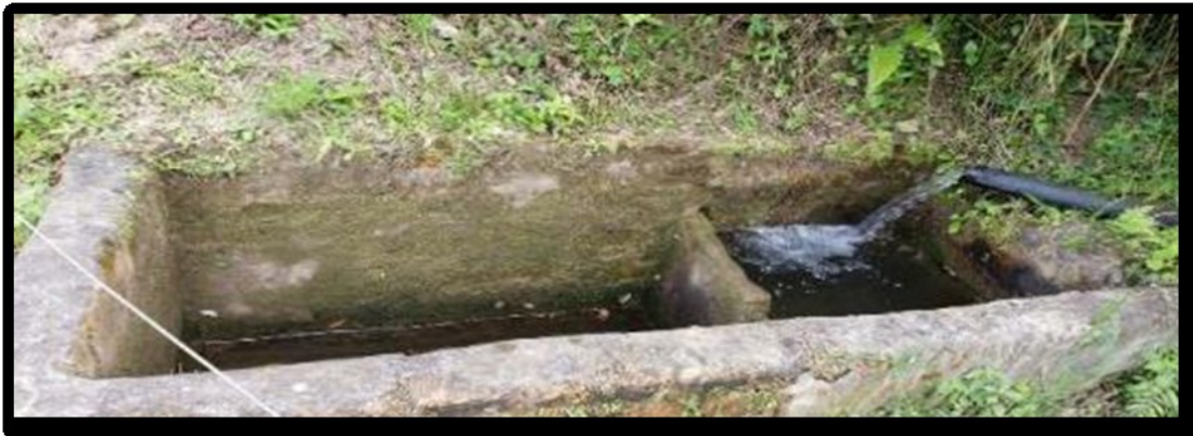
Imagen 3 donde se observa el Tanque desarenador
