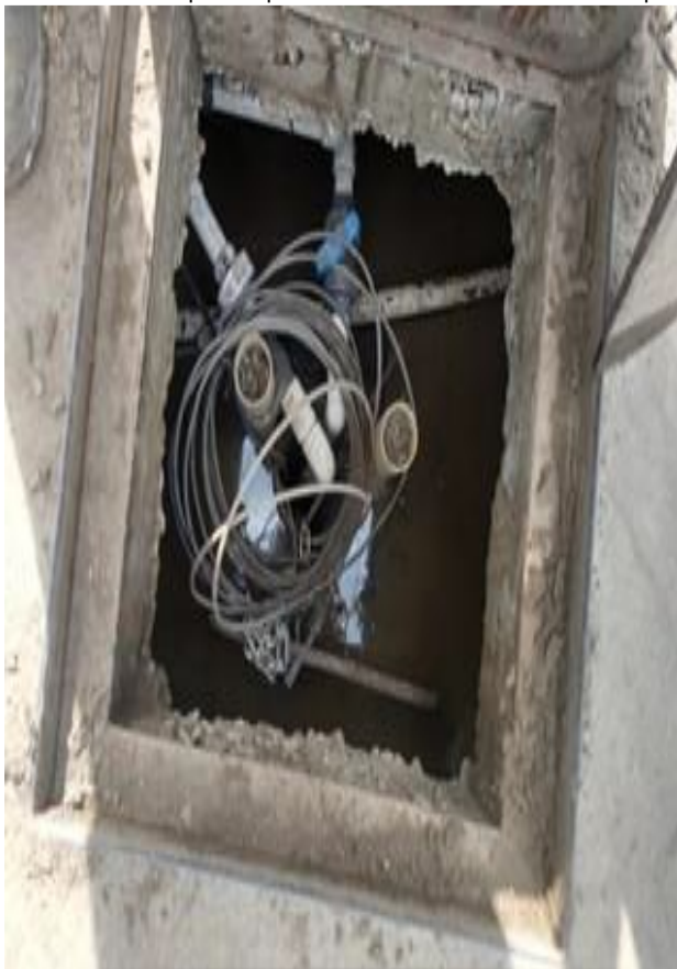
Foto No.1 Vista superior del y Bomba
