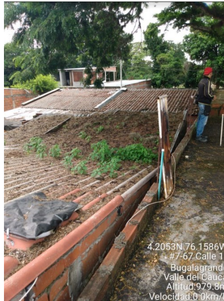
Foto # 5: Biomasa del Samán sobre techos y planchas de viviendas.
