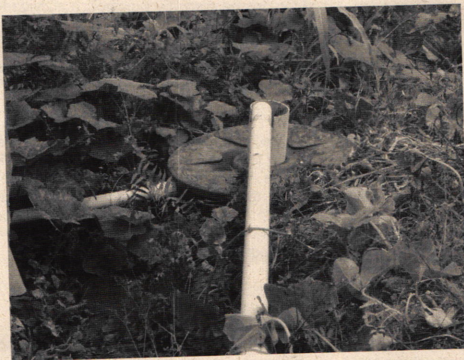
Tanque de rotoplast donde llega inicialmente los efluentes de orina y sobrantes de bebederos.
