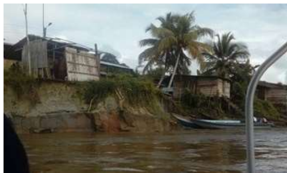
Foto 439. Desprendimiento de la orilla en la comunidad de Veneral del Carmen, río Yurumanguí, Archivo CVC. 2018.
