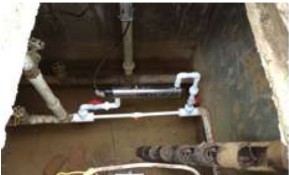
Foto 154. Instalación de sistema de purificación de agua con luz ultravioleta, institución educativa la libertad, municipio de La Cumbre, Bitaco. Dagua, Dar Pacífico Este 2018.
