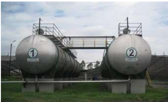
Foto 375. Tanques de almacenamiento de vinazas - Planta de alcohol carburante ingenio Providencia. Archivo CVC. 2018
