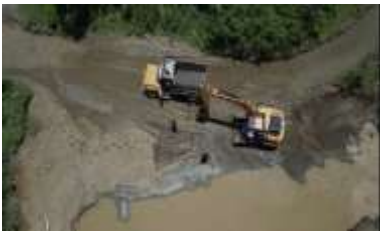
Foto 60. Retroexcavadora y volqueta en actividades extractiva ilegales en el sector Los Kingos de Sevilla.
