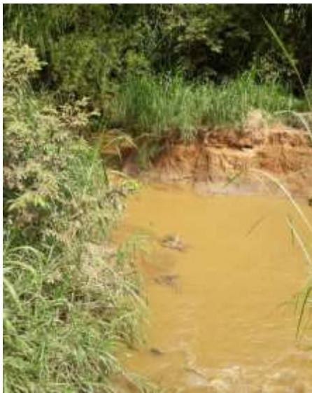
Foto 17. Socavación lateral quebrada La Gaviota, Grupo Gestión del Riesgo y Cambio Climático. DTA, 2018
