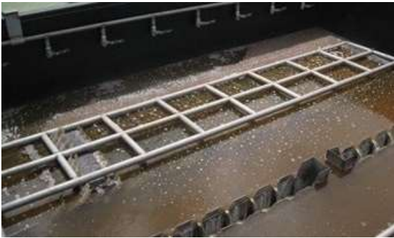
Foto 377. Soportes de las placas sedimentadores en el UASB. Archivo CVC. 2018.
