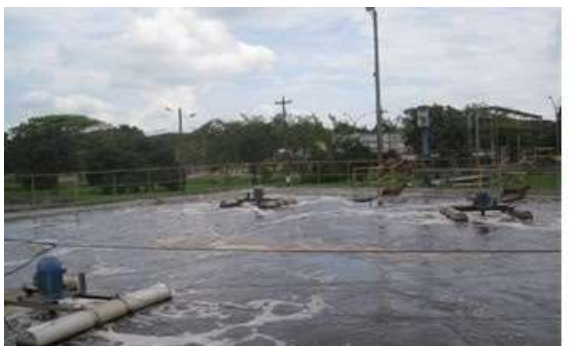
Foto 374. Planta de tratamiento de flemazas y condensados se encuentra en funcionamiento - Planta de alcohol carburante ingenio Providencia. Archivo CVC. 2018
