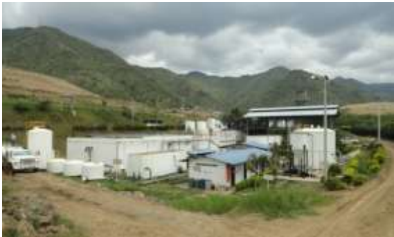
Foto 366. Puesta en marcha de la planta complementaria para tratar lixiviados - Relleno Sanitario Colomba - El Guabal. Archivo CVC. 2018.
