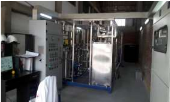
Foto 358. Planta Piloto para la eliminación de PCB mediante Oxidación en Agua Supercrítica primera en Latinoamérica. . Archivo CVC. 2018
