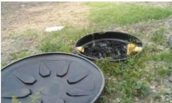
Foto 117. Sistema de tratamiento de Aguas Residuales domésticas. Fuente DAR Centro Norte 2018.
