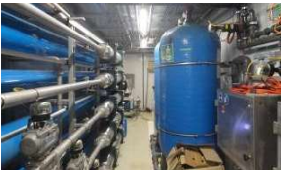
Foto 369. Planta de osmosis - Relleno Sanitario Regional Presidente. Archivo CVC. 2018
