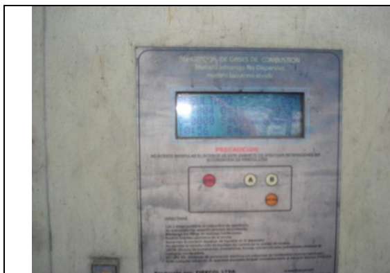
Incineradores Industriales S.A. E.S.P.: Se está
