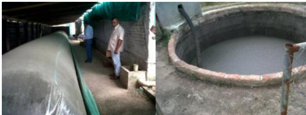
Foto No 1 y 2 Sistema de tratamiento de aguas residuales industriales (porcícolas)
