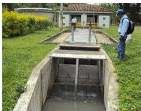
Estructura de llegada de las aguas residuales a la PTAR del municipio de Caicedonia
