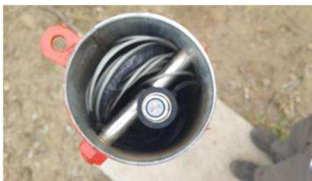
Sensor de medición de nivel (Driver) instalado dentro de la estructura
