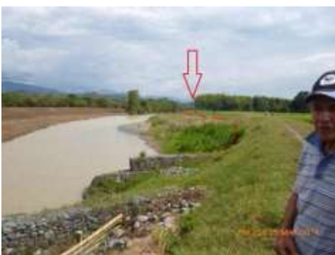
Se evidencia la invasión del cauce sobre la margen izquierda del río, la cual aparentemente se pretende continuar con la construcción de los espolones sobre dicha margen.
