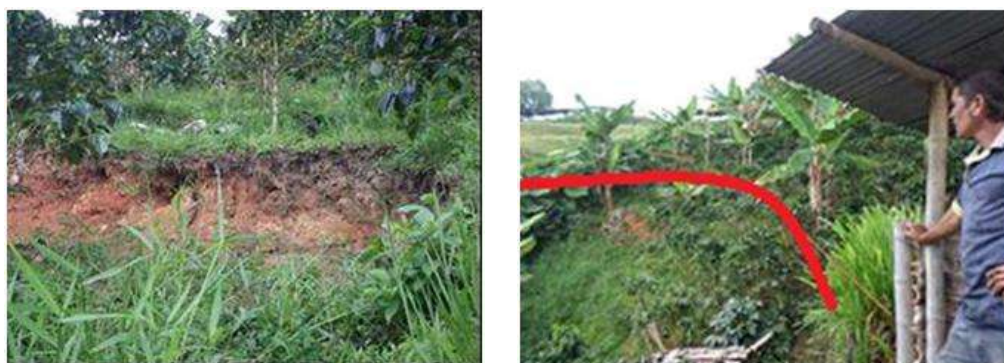
Se aprecia la altura del talud, como consecuencia del hundimiento y desplazamiento del terreno.
