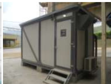
Cabina de control
