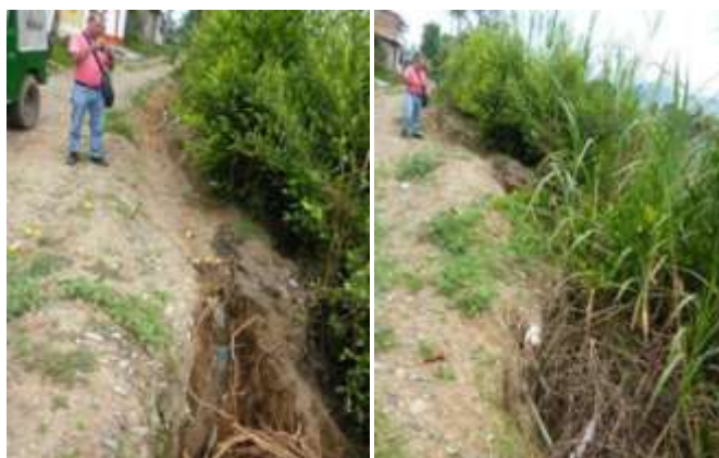
Canal en tierra sobre la vía en talud inferior, facilitando se incremente el riesgo de fallamiento de la vía, afectando progresivamente la estabilidad de las viviendas del sector. Detállese la ubicación de las viviendas en relación al corte del macizo rocoso, donde hay un cambio muy abrupto de plano a pendiente infinita (90°).
