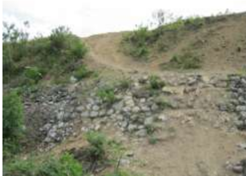
Dique del río Frayle afectado por tránsito de animales, personas y vehículos
