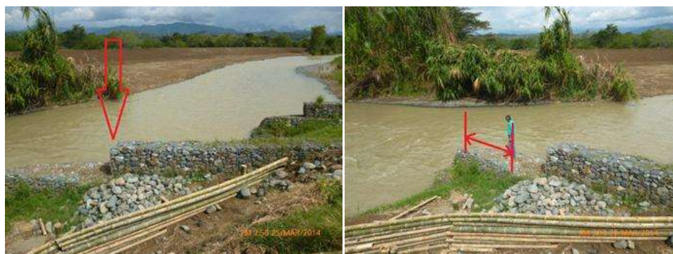
En las fotos se muestra la “invasión” del cauce por la construcción de espolón sobredimensionado y el recorte proyectado del espolón.
