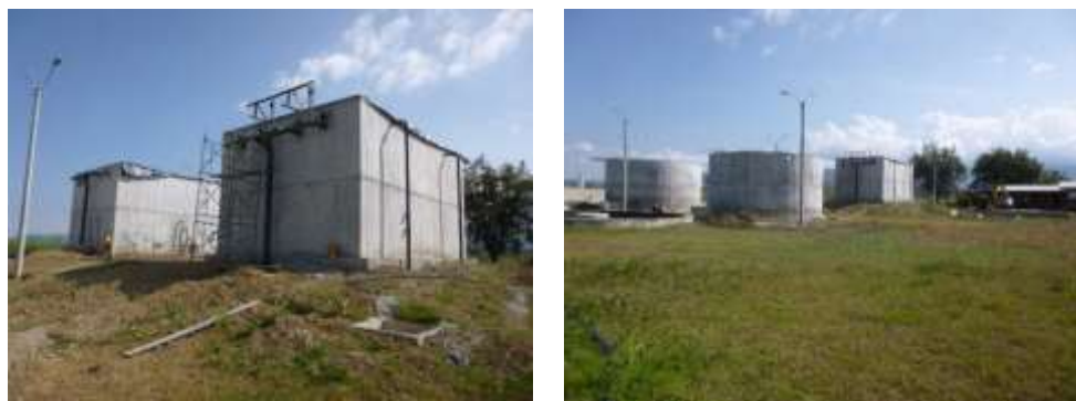
Figura 193. Reactores y filtros percoladores del sistema de tratamiento de aguas residuales del corregimiento de Sonso – Municipio de Guacarí
