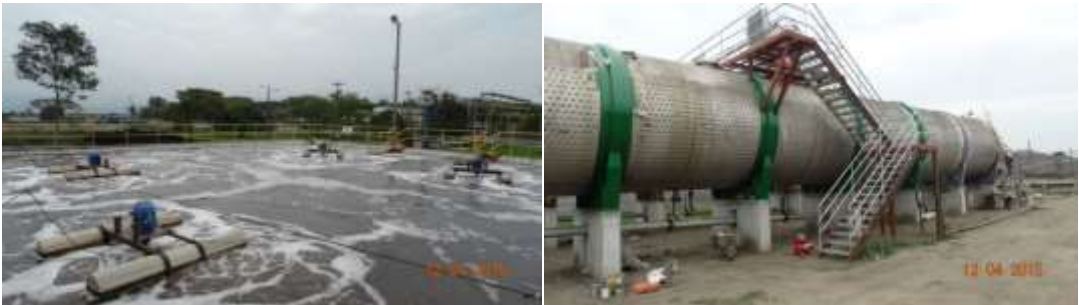
Figura 250. PTAR de Flemazas y condensados tanques para vinaza
