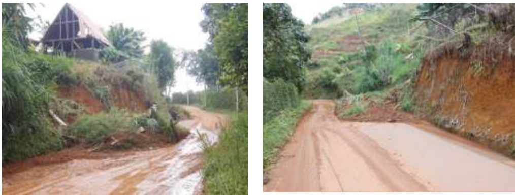
Figura 212. Vista panorámica de deslizamiento
