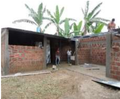
Figura 266. Centro de acopio de residuos sólidos, distribuidos y separados en cuartos separados, en el municipio de Sevilla en la cuenca la Paila. Archivo CVC 2015
