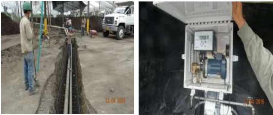
Figura 251. Tuberías para reuso efluente PTAR y equipo control de olores
