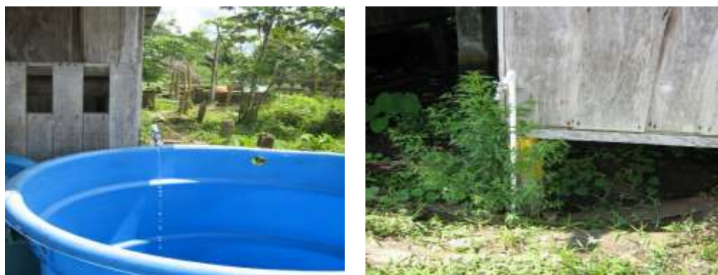
Figura 183. Puntos hidráulicos Vereda Cabeceras- Bajo San Juan- Municipio de Buenaventura. Fuente: Archivo CVC 2015
