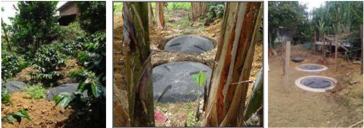
Figura 204. Vivienda Trampa de Grasas, Tanque Séptico Filtro Anaerobico, Yotoco Y Vijes
