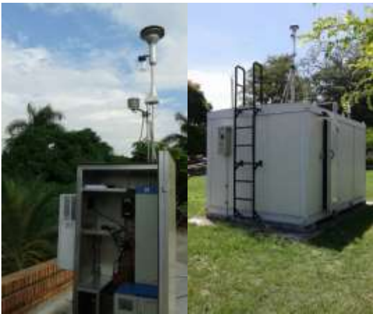
Figura 233. Estaciones de monitoreo de la calidad del aire ubicadas en Acopi (Yumbo) y Tuluá
