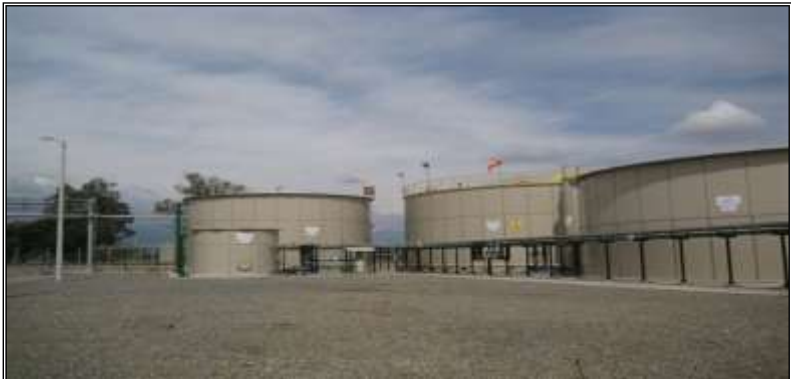
Figura 253. Planta de Tratamiento Aguas Residuales No Domésticas, Riopaila
