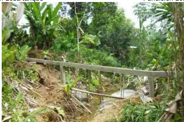
Estructura soporte de tubería en quebrada
