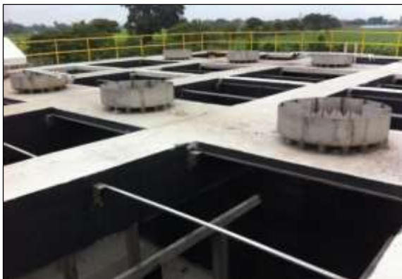
Cajas de distribución de caudales- Reactor UASB obras ejecutadas en la PTAR Candelria
