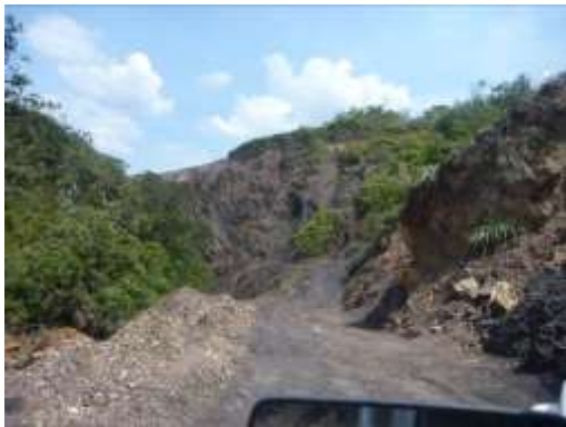
Inestabilidad de taludes por explotación de carbón por minería ilegal.
