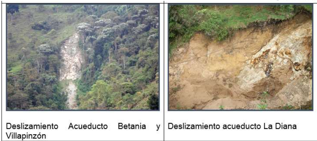
Deslizamientos en el área de influencia de los acueductos priorizados. Fuente: CONSORCIO ASOFRAILE -GAIACOL.
