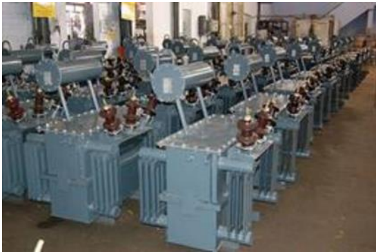
Foto 167. Equipos eléctricos contaminados con PCBs
