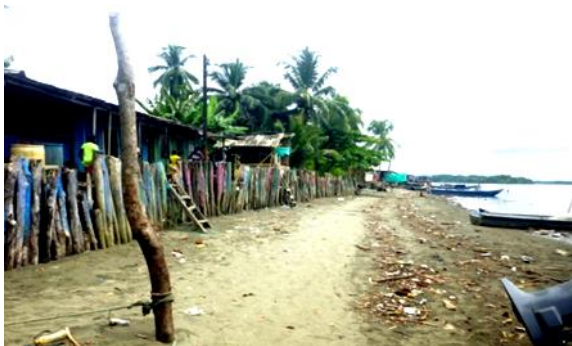
Foto 175. Barreras en madera por proceso de socavación. Archivo CVC 2017
