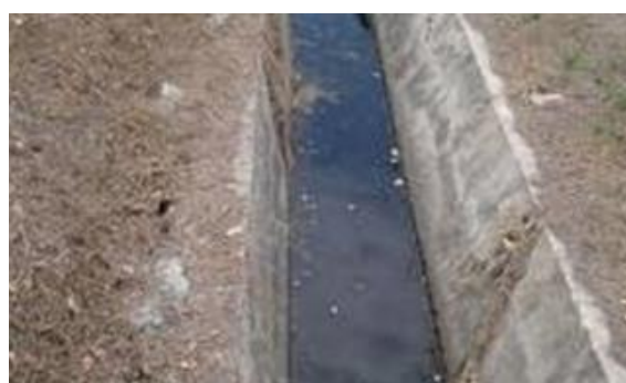
Foto 143. Canales – Aguas de lavado compostaje – Ingenio Mayagüez
