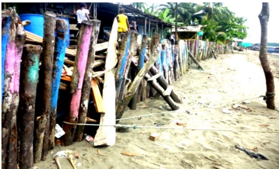
Foto 174. Barreras en madera por proceso de socavación. Archivo CVC 2017
