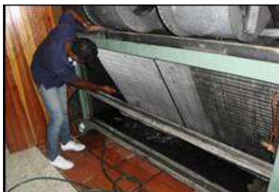
Mantenimiento Aire Acondicionado Central Dirección de Gestión Ambiental
