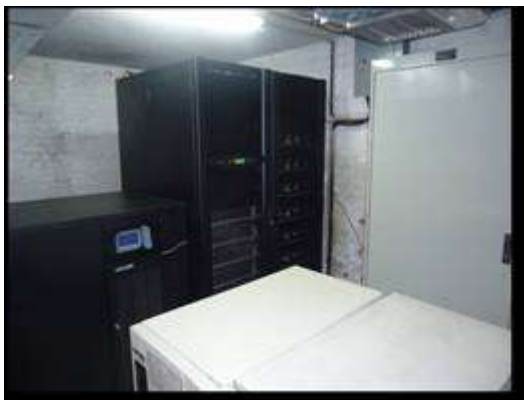
Ubicación de UPS en el sótano
