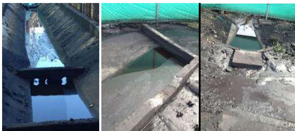
Canales perimetrales y sedimentadores
