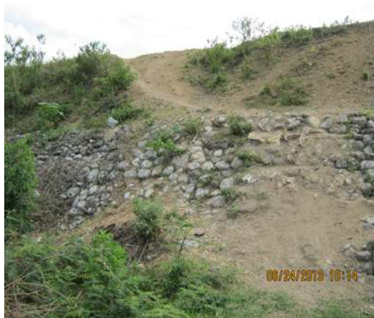
Dique del río Frayle afectado por tránsito de animales, personas y vehículos
