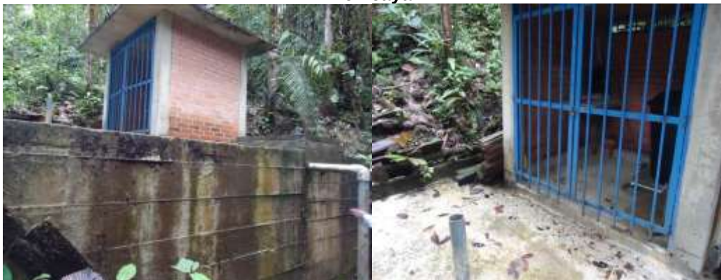
Se observa humedad en las paredes del tanque. Estructuralmente se encuentra en buen estado.
