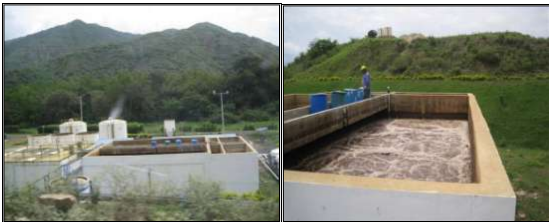
Vista Planta de tratamiento de Lixiviados
