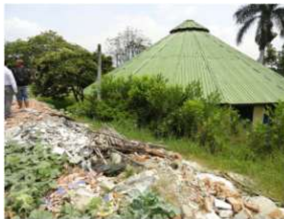
Afectaciones a la infraestructura del polideportivo
