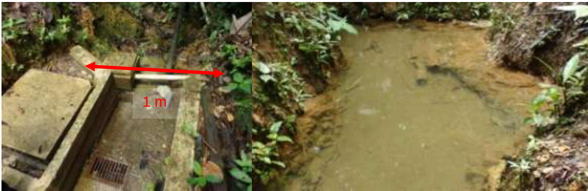
Se observan problemas de estabilidad en los bordes de la presa que pueden generar colmatación por sedimentos.
