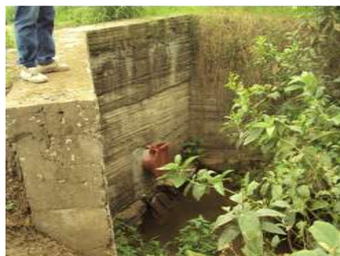
Obra en concreto sobre la cual se ha instalado compuerta y tubería, que impiden el libre flujo de aguas del humedal Timbique hacia el río Bolo y del remanso del río hacia el humedal.
